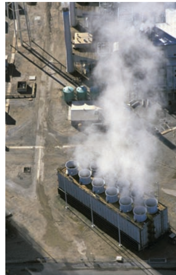
Vista aérea de las torres de refrigeración de Tucson Electric Power, Arizona, Estados Unidos
