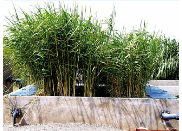
Figure 5: FILTRE PLANTÉ POUR LE TRAITEMENT DES EAUX GRISES
