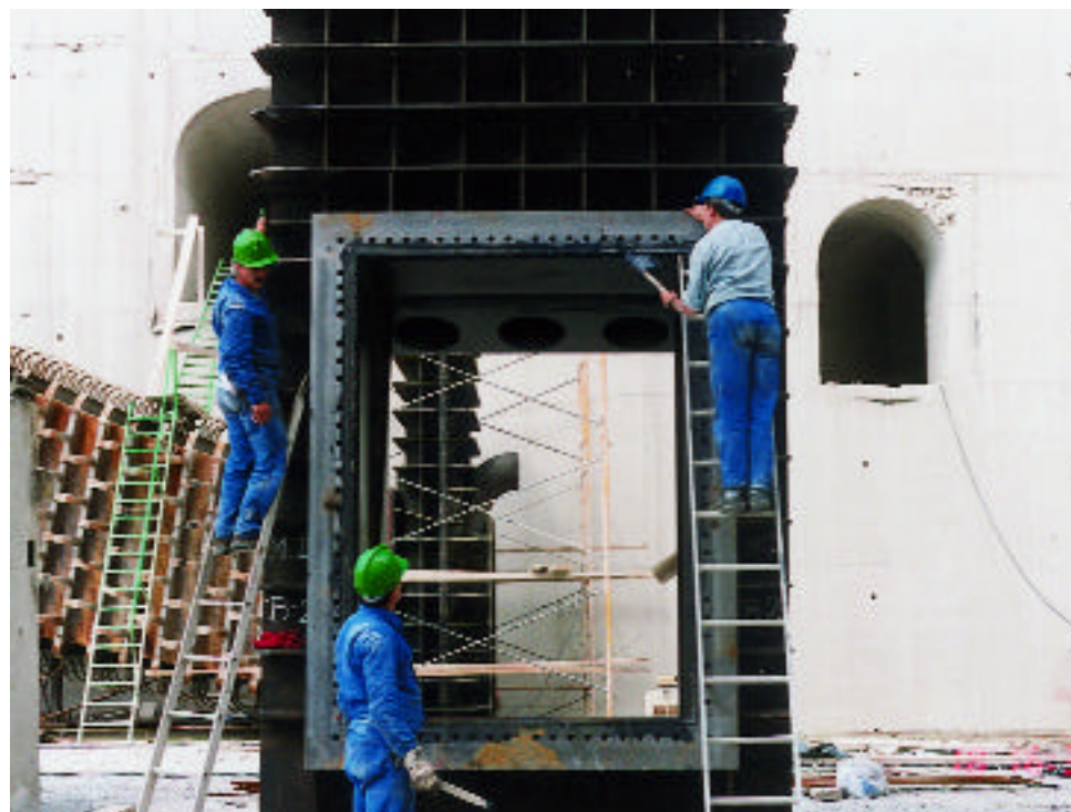
Figura 8. Compuerta Bureau en obra.
