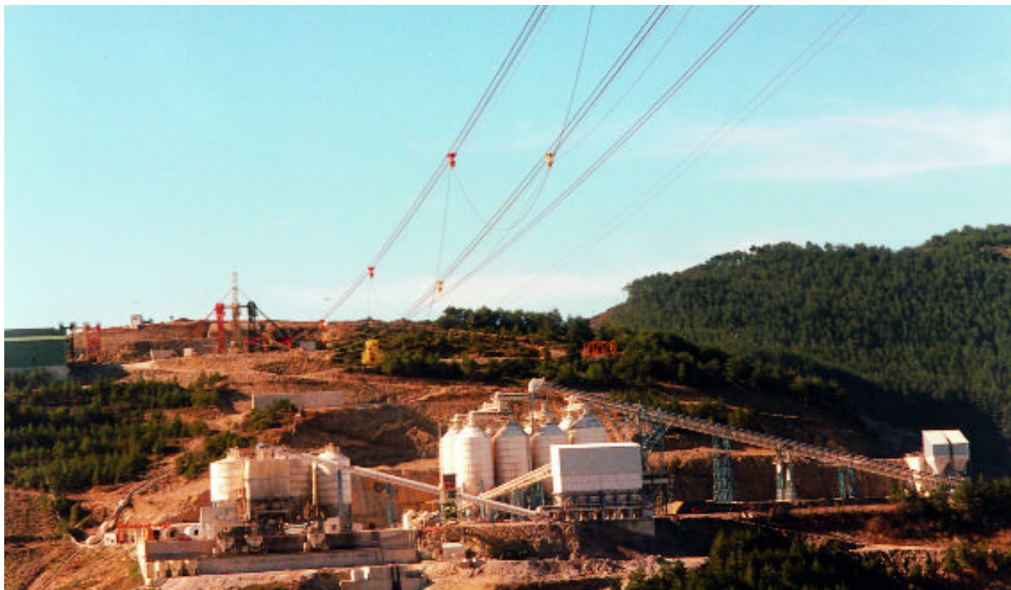
Figura 14. Planta de hormigón.
