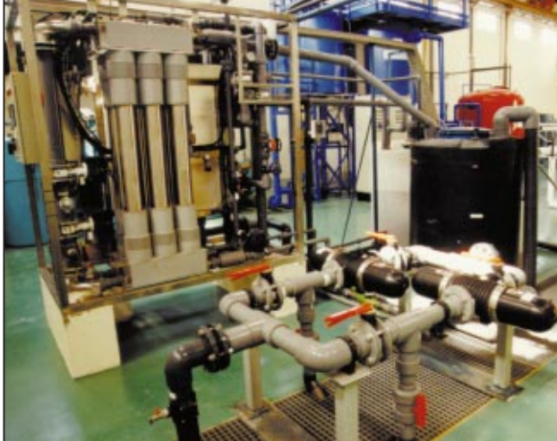
Centro experimental de reutilización de aguas con microfiltración continua. Gran Canaria.
