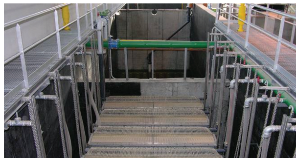
FIGURA 13. Tanque de membranas EDAR Illescas, Toledo.
