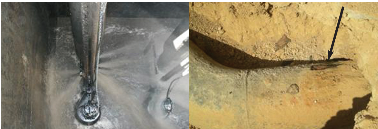
FIGURA 9. Detalle de conducciones dañadas. Disminución rendimiento hidráulico (izq.) y reducción eficiencia aireación (drcha.)
