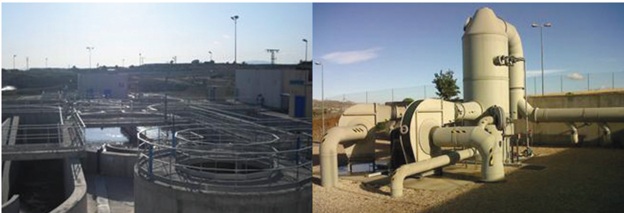
FIGURA 7. Detalle de: Varias líneas de tratamiento biológico (izq.); equipos de extracción de aire viciado de diversas potencias (drcha.)
