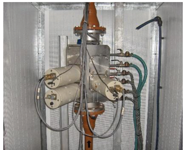
FIGURA 33. Equipo de hidrólisis SONIX en EDAR de Molina de Segura.
