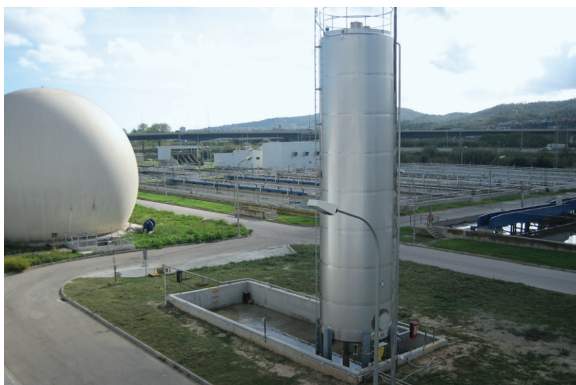
FIGURA 6. Fotografía del silo de almacenamiento de producto y del gasómetro de la EDAR Sant Feliu.
