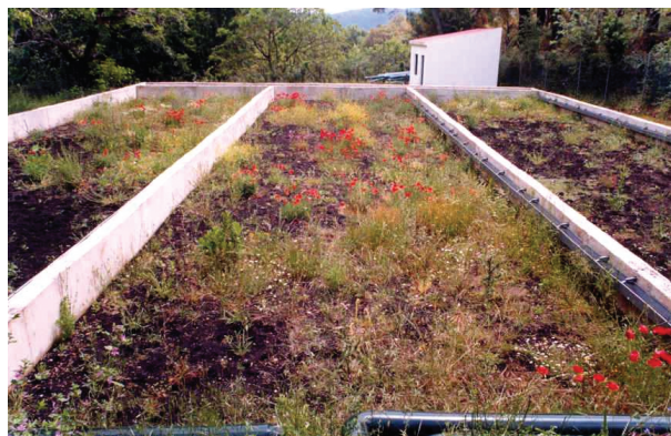
FIGURA 1. Filtros de Turba en estado de abandono.
