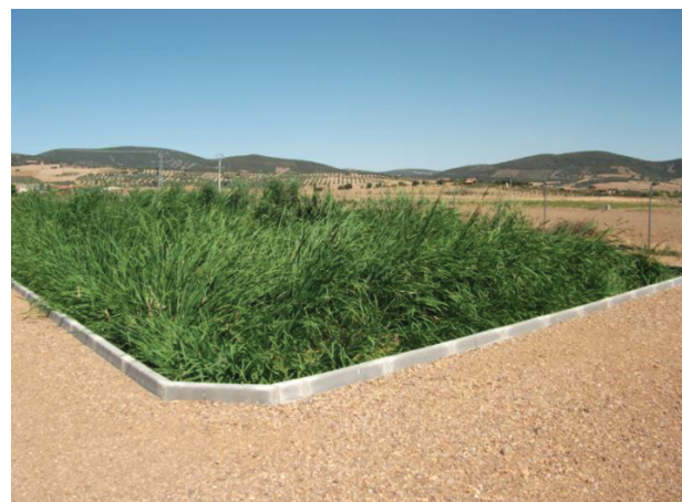
FIGURA 8. EDAR Los Cortijos (Ciudad Real). Fuente: Hidrolution S.L.-Constructora Aglomancha.
