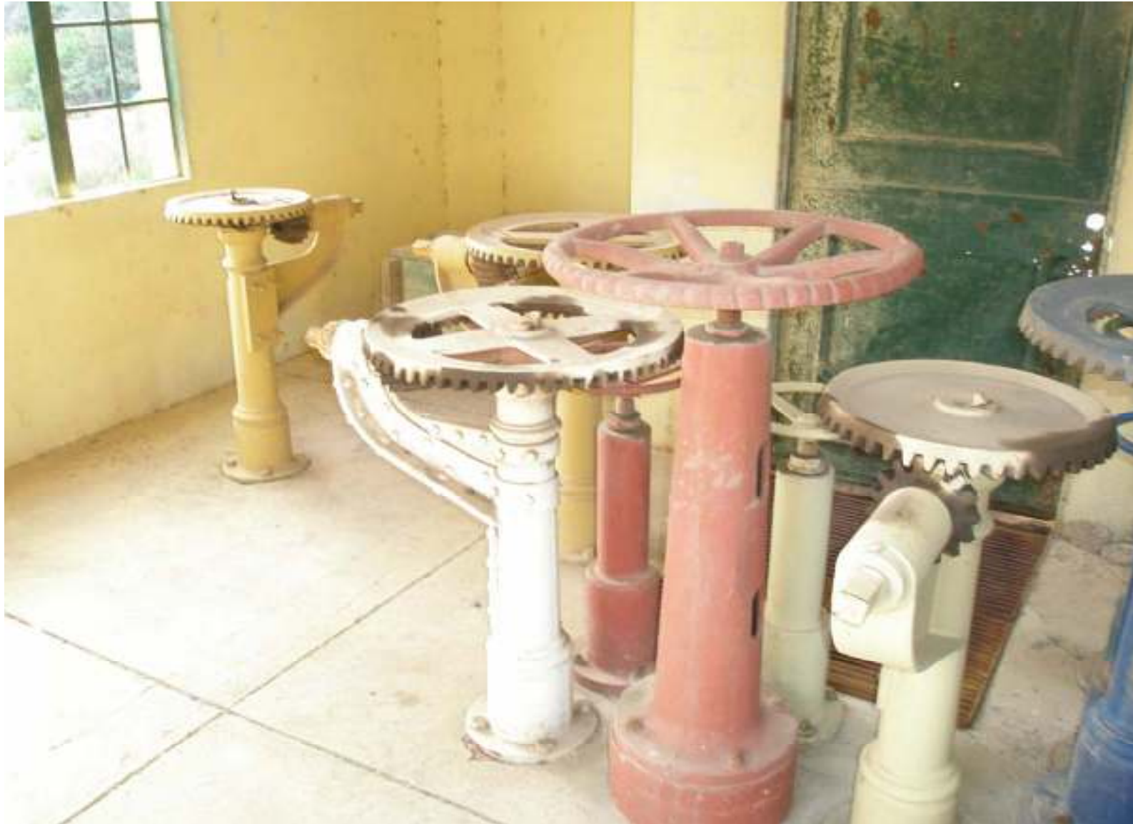
Presa de embalse LOS SAUCES, nivel de comando de válvulas de captación con deterioro edilicio (ítem 43 y 46)
