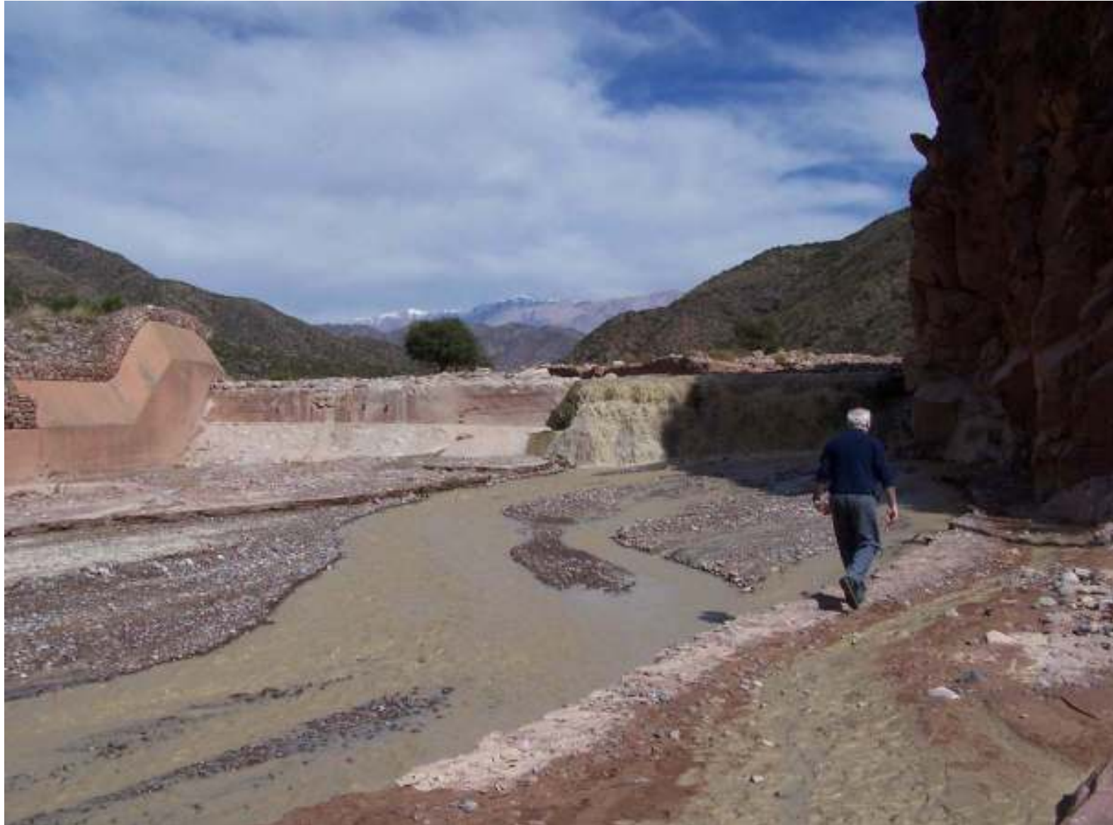
Azud derivación y toma-parrilla CHAÑARMUYO, vista general de la sección vertedero, toma parrilla y muro lateral derecho con deterioros (ítem 118)
