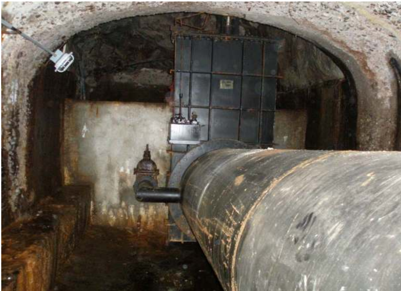
Presas de embalse OLTA, cámara de conducción, compuerta plana y válvula esclusa (ítem 44)
