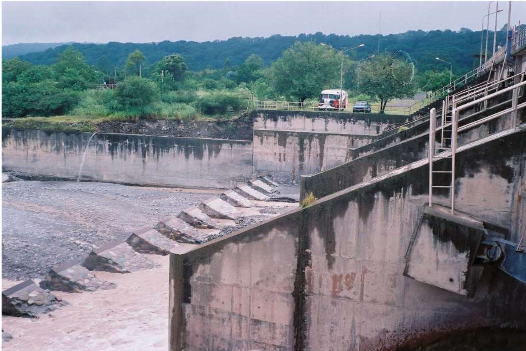
Presa de derivación LOS MOLINOS, disipador de energía atarquinado, sección de restitución al cauce embancada (ítem 21 y 22)
