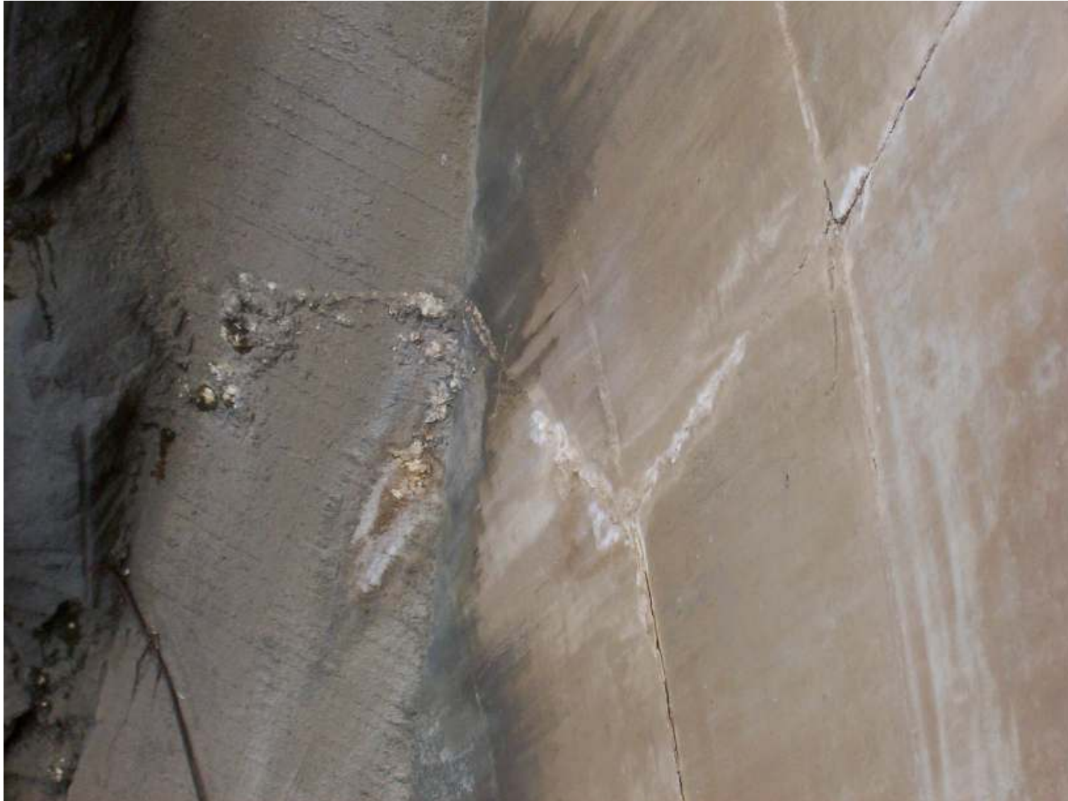
Presas de embalse EL CAJÓN (Córdoba) , vista desde aguas abajo del contacto presa-estribo con depósito de sales por filtración (ítem 90)
