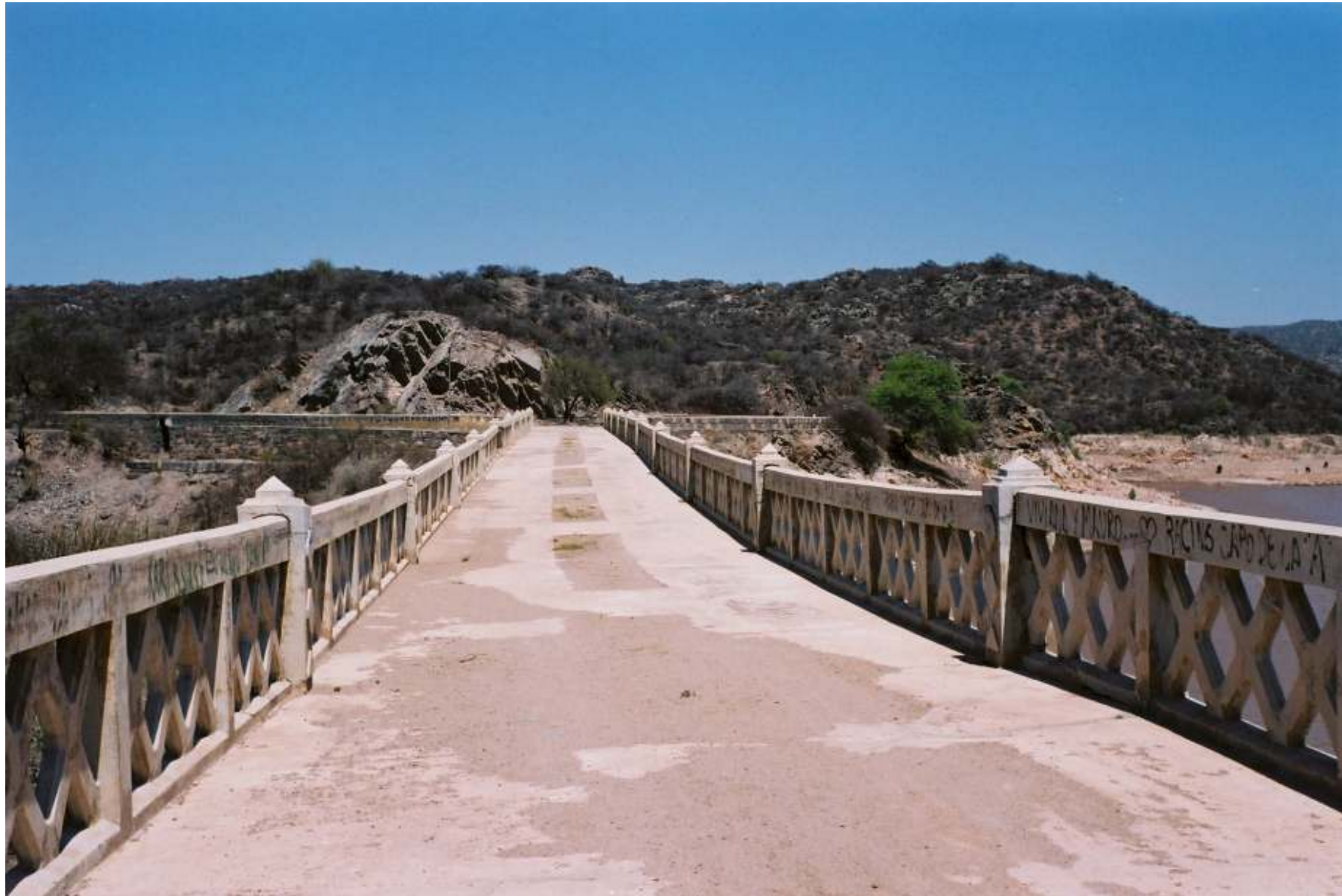
Presa de embalse ANZULÓN, deformación del coronamiento por asentamiento de escollera (ítem 61)
