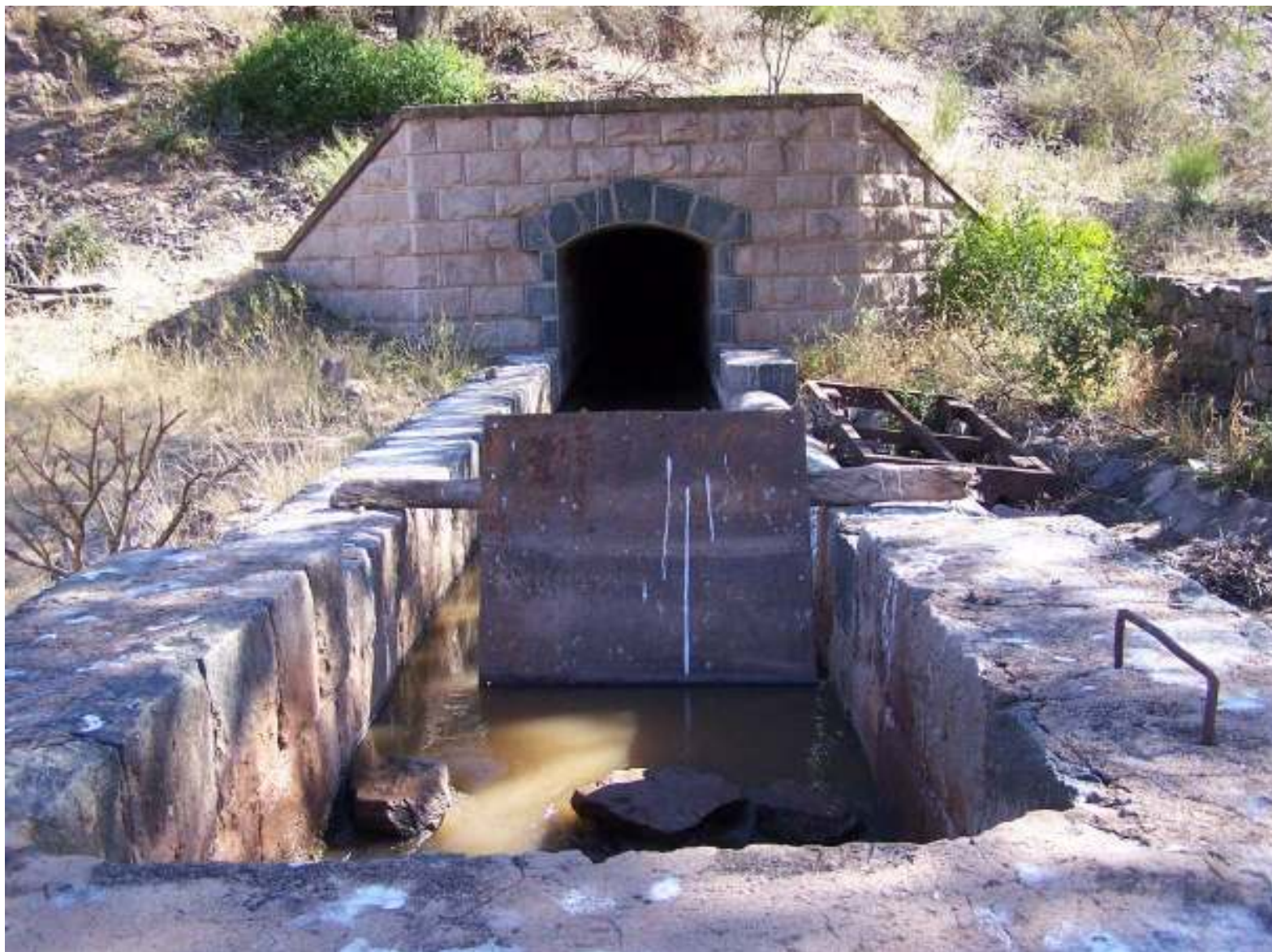
Presa de embalse ANZULÓN, obra de descarga y conducción de caudales para uso consuntivo (ítem 31)
