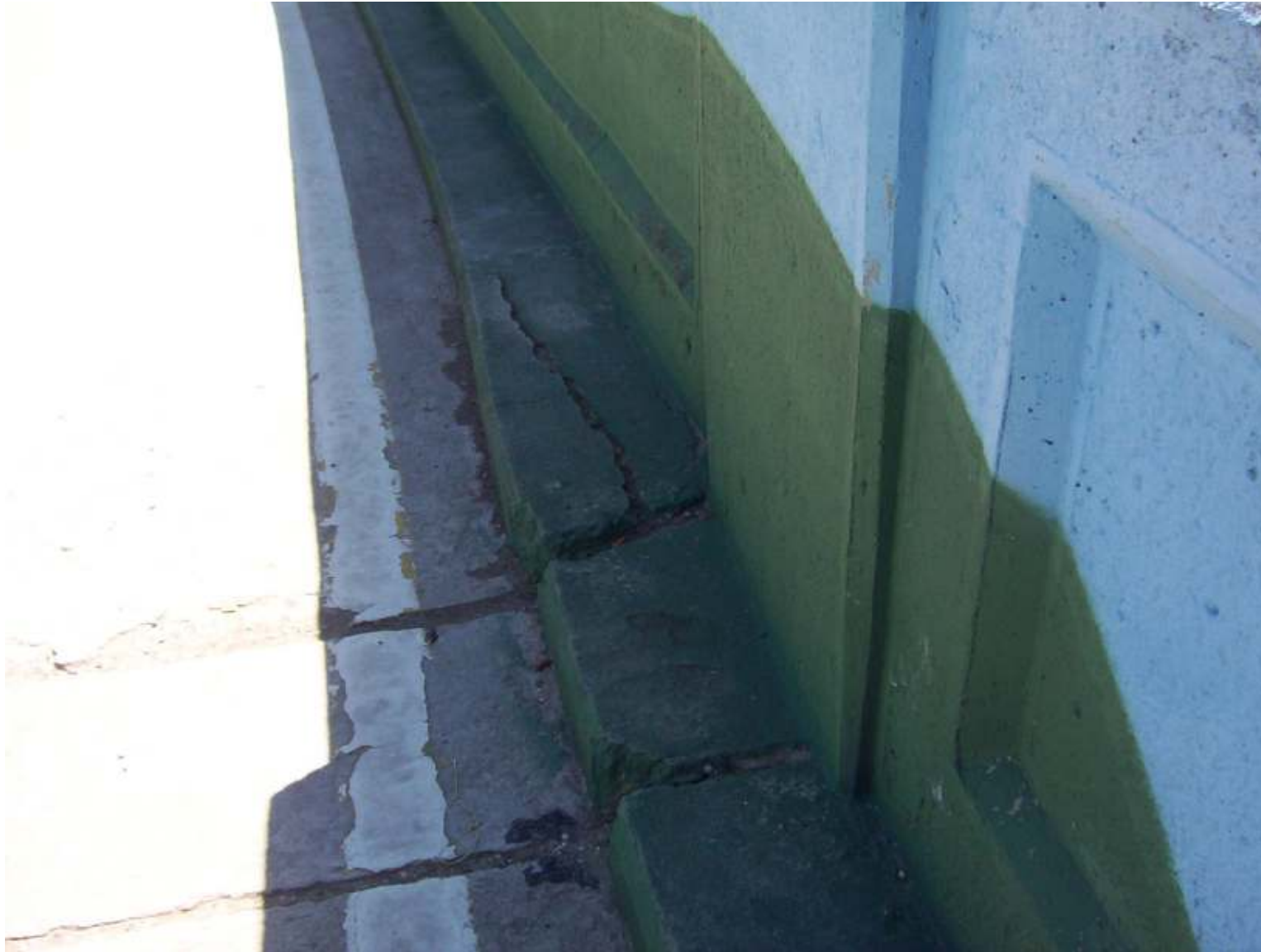
Presa de embalse LOS MOLINOS (Córdoba), fisura en cordón-parapeto del coronamiento (ítem 86)
