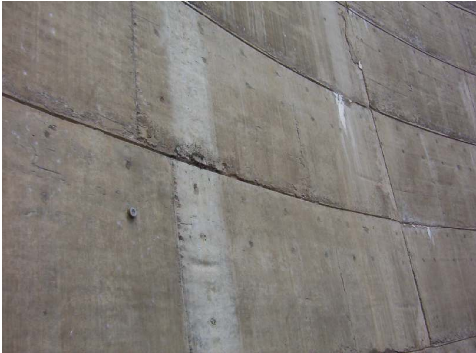
Presas de embalse EL CAJÓN (Córdoba), juntas de construcción entre tongadas de hormigón (ítem 92)
