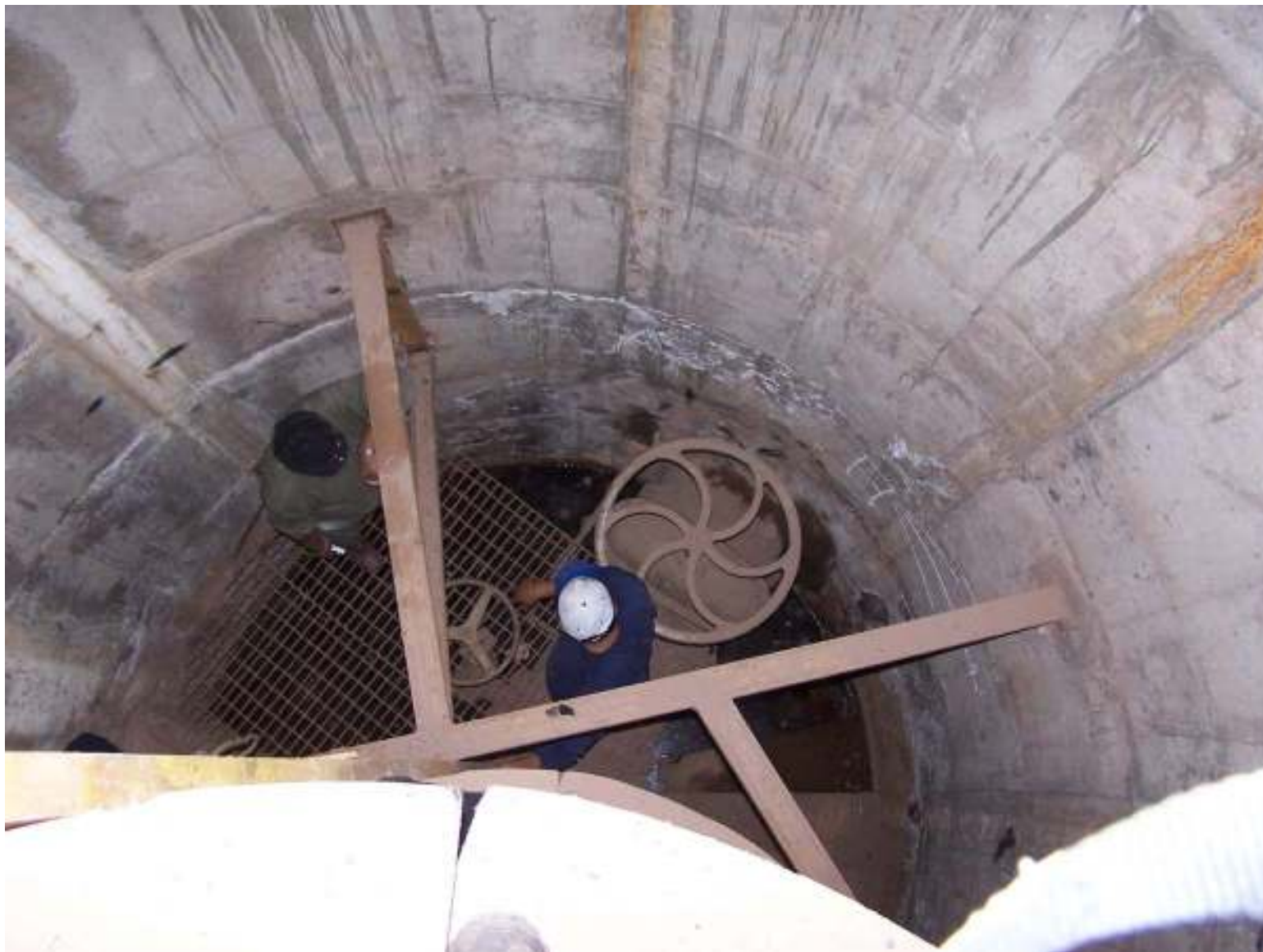
Presas de embalse CHAÑARMUYO, nivel de válvulas esclusa para captación de caudales en obra de toma (ítem 43)
