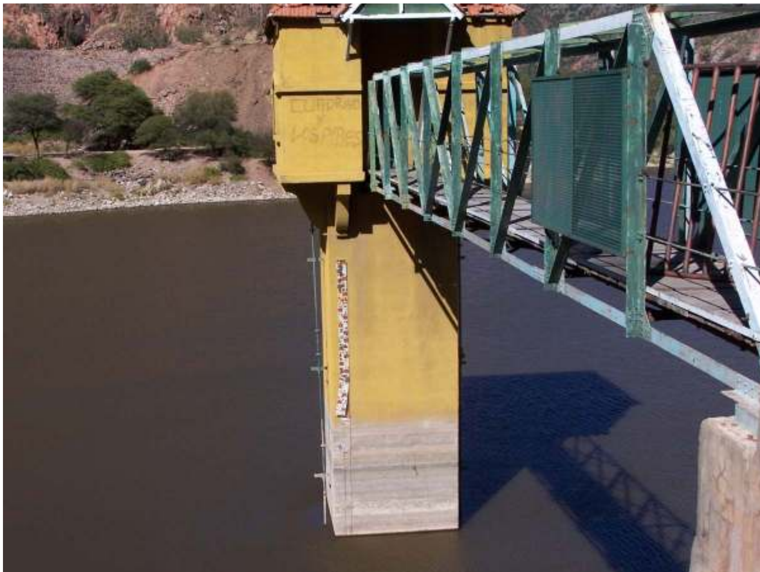
Presa de embalse LOS SAUCES, acceso a obra de toma y deterioro de escala de medición de nivel del embalse (ítem 30)
