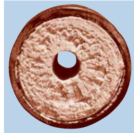
Fig. 2 – Incrustación calcárea en una tubería
