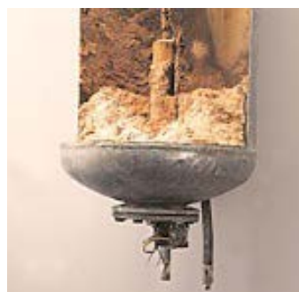
Fig. 13 Incrustación calcárea en el interior de un acumulador de agua
