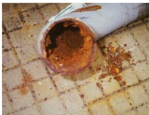
Fig.17 Corrosión de un tubo de acero negro
