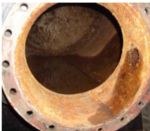
Fig. 15 Corrosión de un acumulador de acero al carbono
