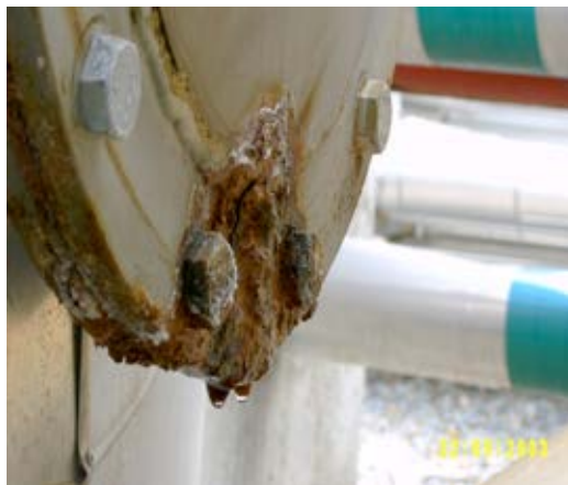
Fig. 14 Corrosión de un acumulador de acero inoxidable
