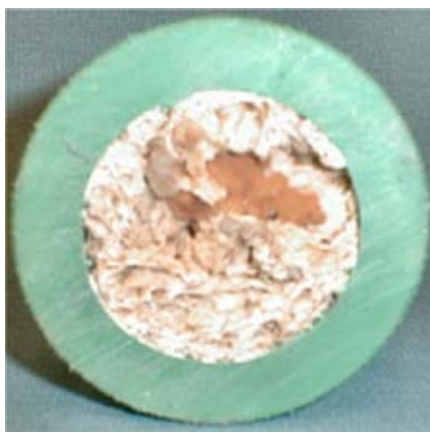
Fig. 20 Incrustación calcárea en tubería de torre de refrigeración
