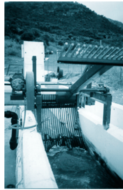
FOTOGRAFÍA 4. Reja curva de accionamiento automático.
