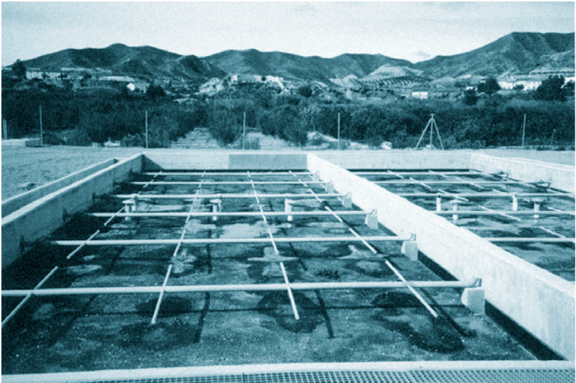
FOTOGRAFÍA 29. Filtros de turba.
