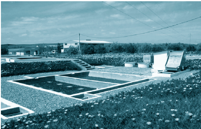
FOTOGRAFÍA 1. Instalación de tratamiento mediante filtro de turba, en la que se observa el tamiz autolimpiante, ubicado sobre un desengrasador estático, y los filtros de turba.
