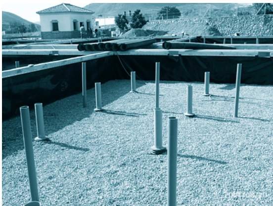
FOTOGRAFÍA 7. Chimeneas de ventilación del sustrato filtrante.
