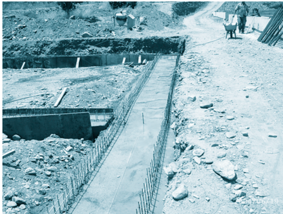
FOTOGRAFÍA 3. Construcción en hormigón de los muros verticales de una instalación de filtros de turba.
