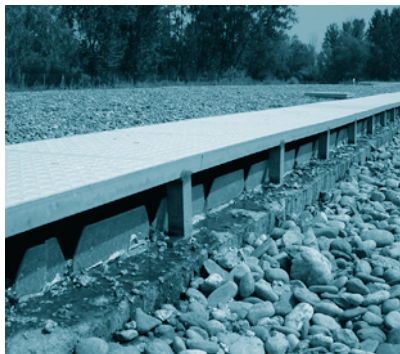
FOTOGRAFÍA 16. Reparto de la alimentación a un HAFSs horizontal mediante vertedero Thompson. (EDAR de Corbins, Lleida)
