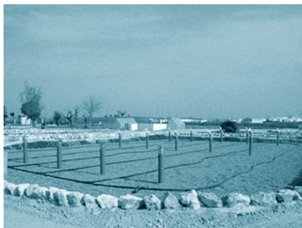
FOTOGRAFÍA 17. Tuberías para el reparto de la alimentación en un HAFSs vertical (PECC)
