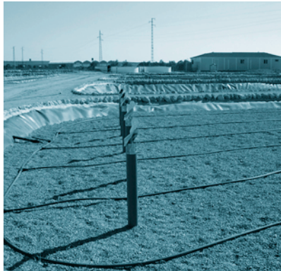
FOTOGRAFÍA 12. Detalle de las chimeneas de ventilación en un HAFSs Vertical.
