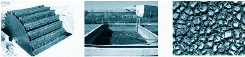
FOTOGRAFÍA 17. Contactor biológico rotativo, filtro de turba en sustitución de la etapa de decantación secundaria y aspecto de los lodos secos. Planta Experimental de Carrión de los Céspedes.
