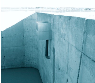
FOTOGRAFÍA 31. Detalle del vertedero de salida.
